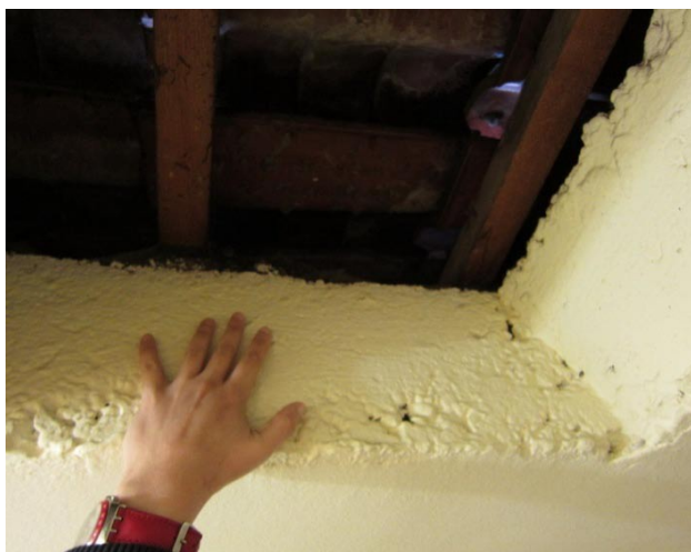
Krovni otvor, vidi se debljina krovne ploče, bez termoizolacije
