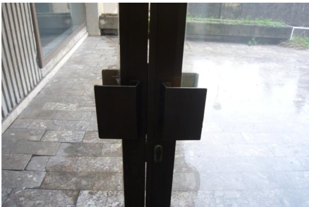
Detalj lošeg zatvaranja postojećih Al vrata na jednom od izlaza na terasu
