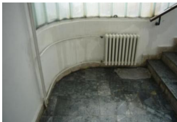
Prozori na stepeništu propuštaju kišu
